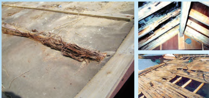
腐朽した木材や合板
