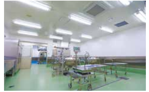
学校給食センター (使用場所: 加熱調理室等 天井)
