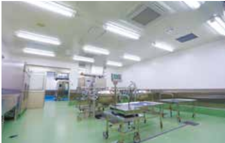
学校給食センター (使用場所：加熱調理室等 天井)
