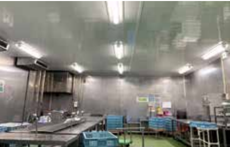
水産加工工場 (使用箇所：加工場 天井)
