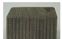
木製デッキ穴明き・割れ・変色
