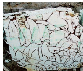
断熱材の中の蟻道
