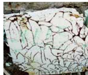
断熱材の中の蟻道
