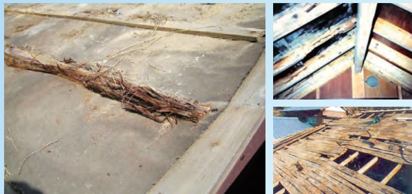
腐朽した木材や合板
