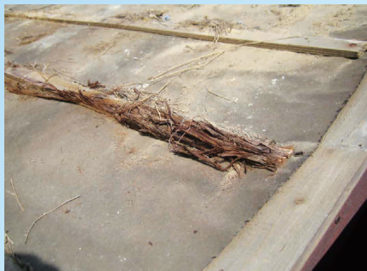
腐朽した木材や合板
